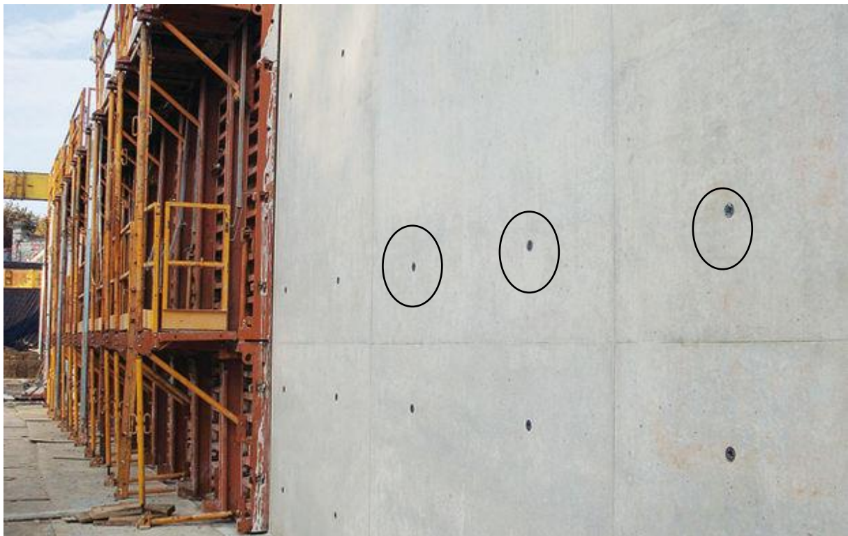
Figure 26 : Illustration de ce que sont les trous de banche, nécessaires dans le montage des murs béton - lemoniteur.fr
